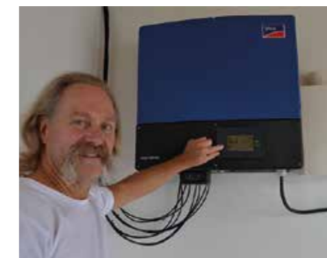
FULL KONTROLL. På panelen kan familjen ha koll på effekten. Just nu ger solcellerna sju kW.
