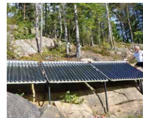
SJÄLVFÖRSÖRJANDE. Solpanelerna på bergskanten bakom gästhuset försörjer fastigheten med varmvatten.
