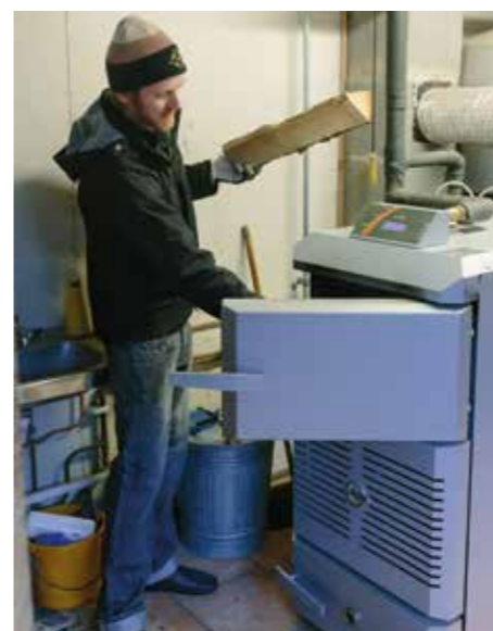
I GARAGET. Pannrum och vedförråd är placerade i en separat byggnad. Värmen går via två kulvertar till bostadshus och företagsbyggnad.
